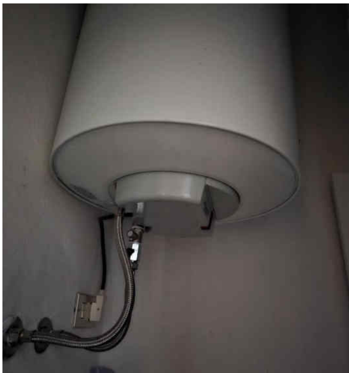
Foto n° 19 – Boiler ACS lavanderia
